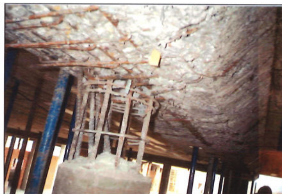
Defecto en zona de gran densidad de armaduras (Obsérvese que el tramo superior del pilar, hormigonado conjuntamente con la viga, queda sin aporte de hormigón) Defect on the reinforcement high density zone (Notice that the top of the column remains without concrete inflow)
