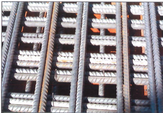
Zona de gran densidad de armaduras Zone with a high density of reinforcement
