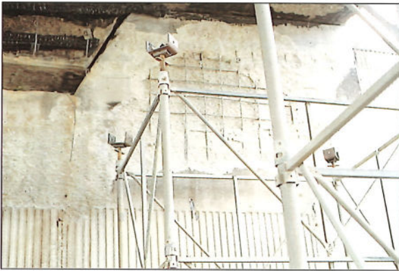
12. DAÑOS POR INCENDIO EN EL ESTRIBO DE UN PUENTE. 12. FIRE DAMAGE TO A BRIDGE ABUTMENT.
