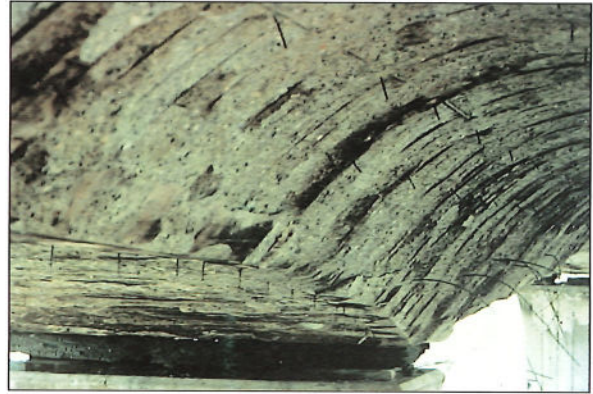
11. DAÑOS EN LOS APOYOS EN EL CASO DE LA FOTO N.º 10. 11. DAMAGE TO SUPPORTS TO THE DECK SHOWN IN PHOTOGRAPH 10.
