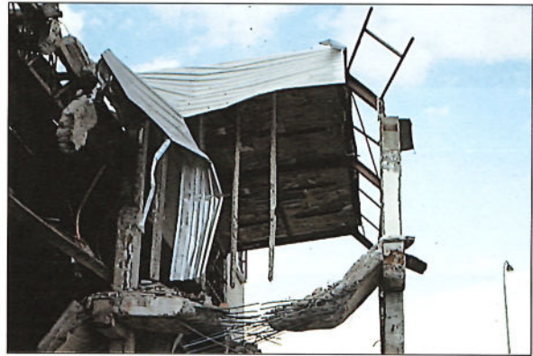
13. HUNDIMIENTO PARCIAL DE ESCALERA DURANTE UN INCENDIO. 13. PARTIAL COLLAPSE OF A STAIRWAY DURING A FIRE.
