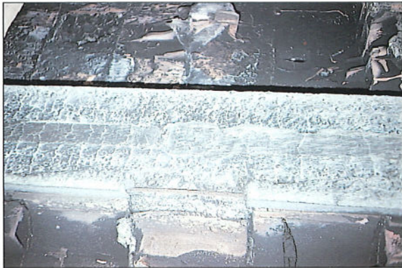
1. FISURACIÓN CARACTERÍSTICA "EN PIEL DE COCODRILO" DE VIGA DAÑADA POR EL FUEGO. 1. CHARACTERISTIC "ALLIGATORING" CRACKING OF A FIRE DAMAGED BEAM.
