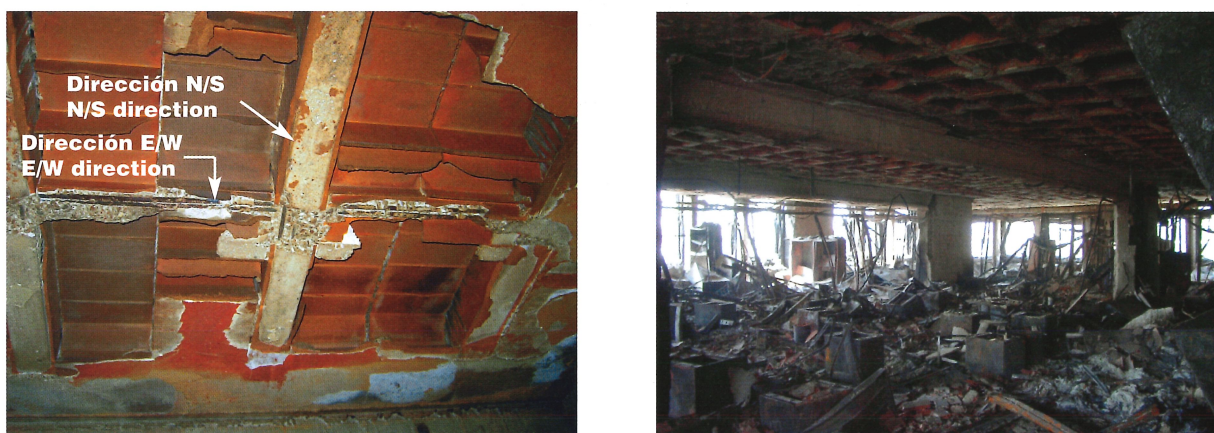
Figura 20. Desprendimiento de falsos techos y fondo de bovedillas. Se aprecia la configuración del forjado reticular, con nervios ortogonales y bovedillas cerámicas. Figure 20. Detached suspended ceilings and bottoms of pan forms. Note the two-way slab layout, with horizontal ribs and clay-base pan forms.
