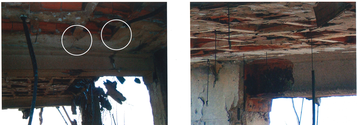
Figura 19. Daños o defectos en el revestimiento antifuego de los perfiles de las vigas mixtas Figure 19. Damage or flaws in the fireproofing on composite beam sections
