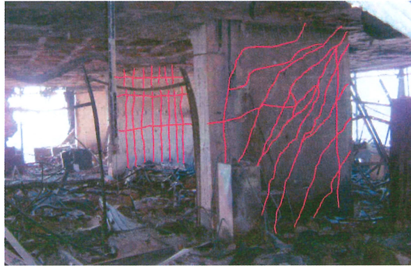
Figura 16. Fisuración en pilares de planta 16 Figure 16. Cracking on 16 th storey columns
