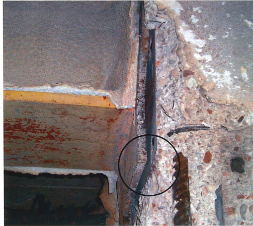
Figura 18. Rotura de soldadura en anclaje Figure 18. Broken anchor weld
