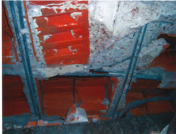
Figura 21. Desprendimiento del recubrimiento de la armadura positiva. Figure 21. Detached concrete cover, bared positive reinforcement
