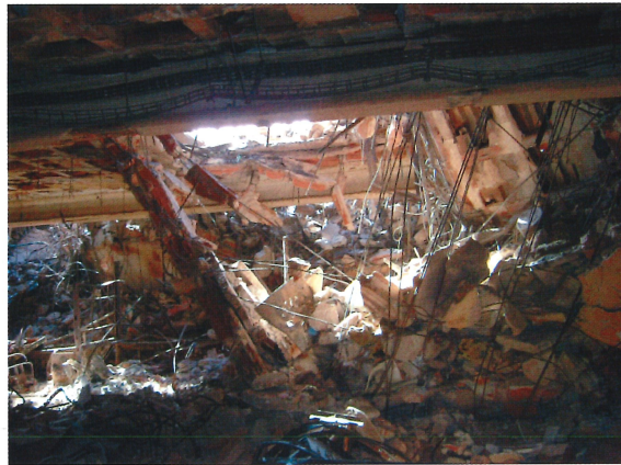
Figura 12. Escombros acumulados en la planta 17 aflorando en la 18 Figure 12. Rubble on the 17 th storey, piled up to the 18 th
