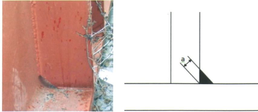
Figure 1. Paucity of filler material Figura 1. Escasez de material de aportación
