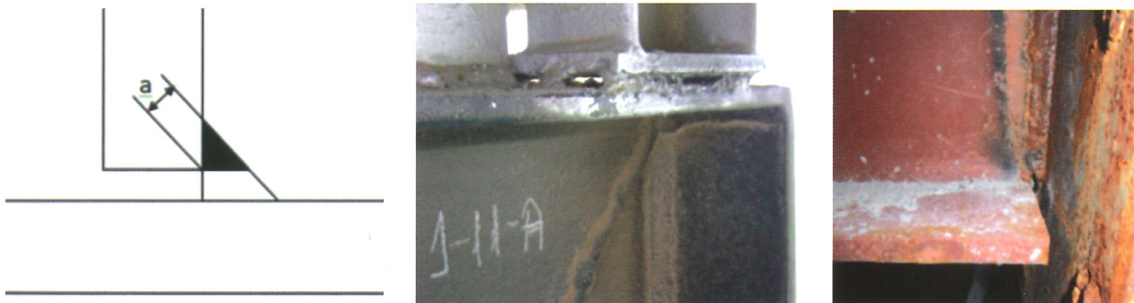
Figure 2. Excessive gaps Figura 2. Separaciones excesivas
