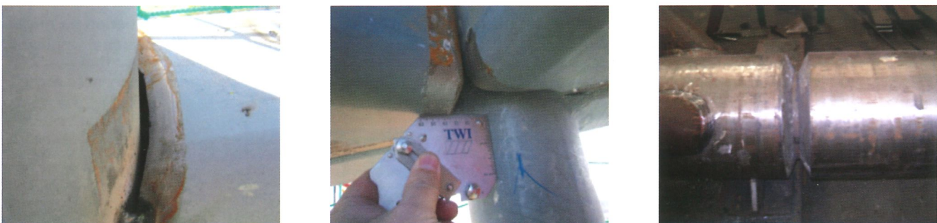
Figure 13. Excessive gaps and back-up flatbars in tube joints Figura 13. Separaciones excesivas y disposición de respaldo en caso de unión entre tubos
