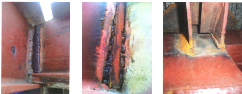
Figura 7. Relleno inadecuado de separaciones Figure 7. Inappropriate gap fillings
