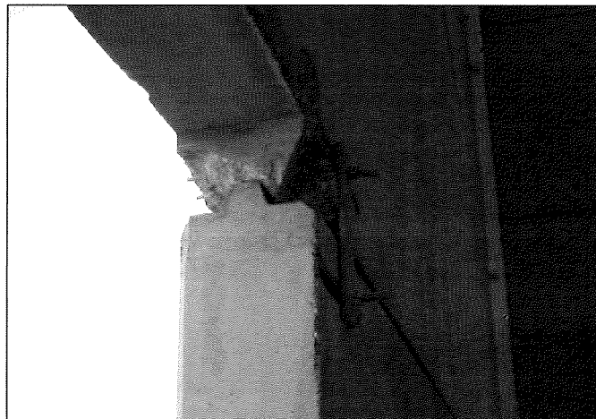
Figure 21. Façade panel spalling due to localised stress Figura 21. Descantillado en paneles de fachada por tensiones localizadas
