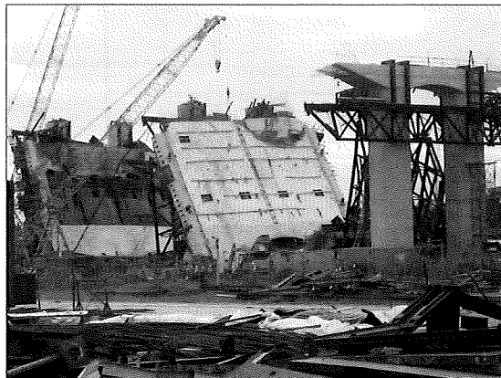
Fotografía 35. Vano de acceso del puente Can Tho colapsado Photograph 35. Approach span on Can Tho Bridge after collapse
