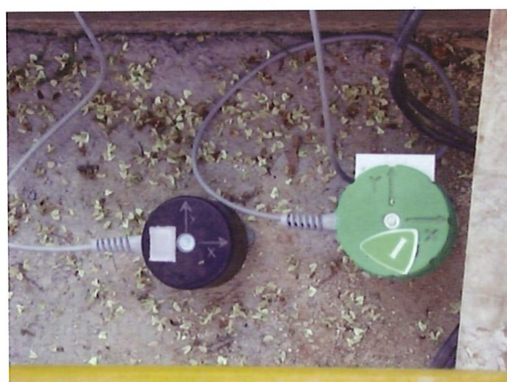
Control de vibraciones Vibration monitoring
