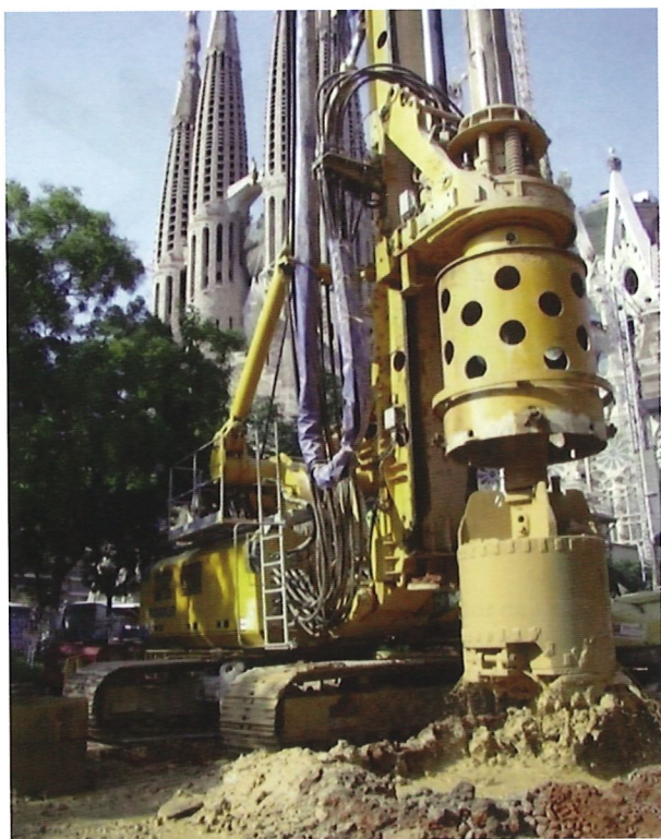
Vista de una de las fases de la ejecución Pile wall construction
