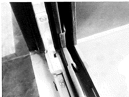
Fotografía n° 8: Pieza especial de unión de perfiles de junta de estanqueidad, no adherida correctamente a éstos. Photograph 8: special piece for joining two watertight gaskets, incorrectly fitted.
