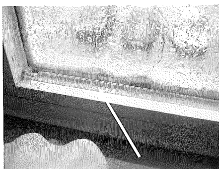
Fotografía nº 13: Sellado realizado sobre silicona y suciedad preexistentes. Photograph 13: sealant applied to a soiled surface, over existing layers of silicone.
