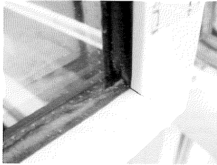
Photograph 10: gap in (rubber) gasket at corner. Fotografía n° 10: Defecto de ajuste del perfil de sellado (goma) en esquina.
