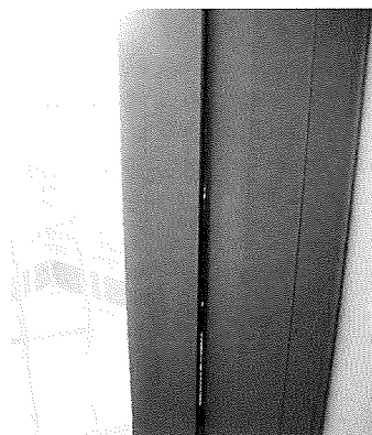
Fotografía n° 18: Defecto de ajuste de perfiles en posición cerrada de la carpintería. Photograph 18: misaligned profiles, preventing tight closure.
