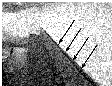
Fotografía nº 22: Desajuste con el paramento del cajón de persiana en su parte superior. Photograph 22: Misalignment between top of drum compartment and wall.
