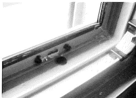
Photograph 21: unsealed anchor in area exposed to water. Fotografía nº 21: Anclaje sin sellar dispuesto en zona de paso de agua.
