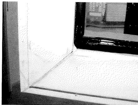
Photograph 1: mitred joints with poorly aligned profiles, sealed a posteriori. Fotografía nº 1: Encuentro de perfiles "a inglete" no ajustados y sellados "a posteriori".
