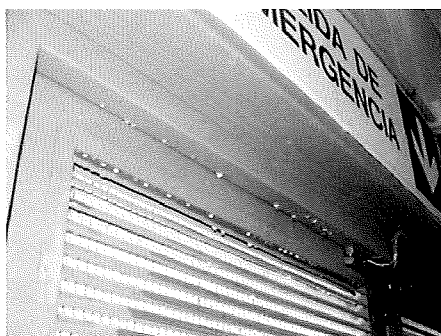
Fotografía nº 25: Filtraciones de agua en carpintería con apertura al exterior. Photograph 25: leaks in outward opening joinery.
