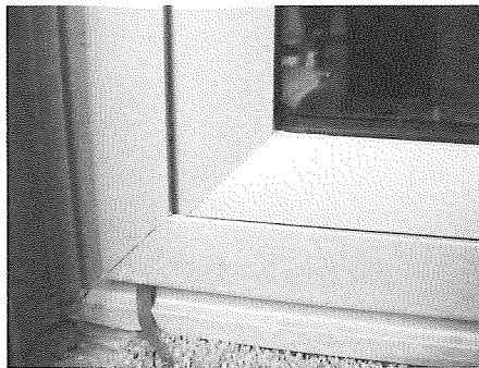
Fotografía nº 27: Hoja de puerta descolgada por defecto de anclaje del montante del cerco. Photograph 27: door leaf yielding due to faulty anchorage on frame upright.
