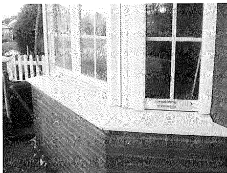
Fotografía n° 20: Junta entre piezas de alféizar, y encuentro para sellar contra la jamba. Photograph 20: joint on window sill and abutment with jamb, to be sealed.
