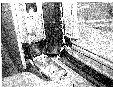
Fotografía n° 9: Encuentro defectuoso de la junta entre hojas con la junta central del canal inferior de evacuación. Photograph 9: misalignment of joint between casements and the central joint in the bottom drainage channel.
