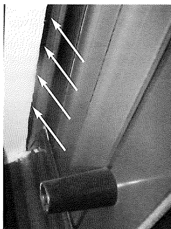
Photograph 24: abutment between blind drum compartment and lintel. Note area open to passage of air to inner air space. Fotografía n° 24: Encuentro del cajón de persiana con dintel. Obsérvese la zona de paso de aire a la cámara interior.
