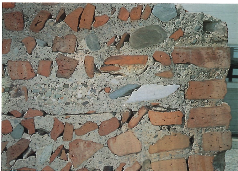
Foto 3. Sección que muestra la fábrica de la Torre colapsada: capa de ladrillo y relleno de cascotes.
