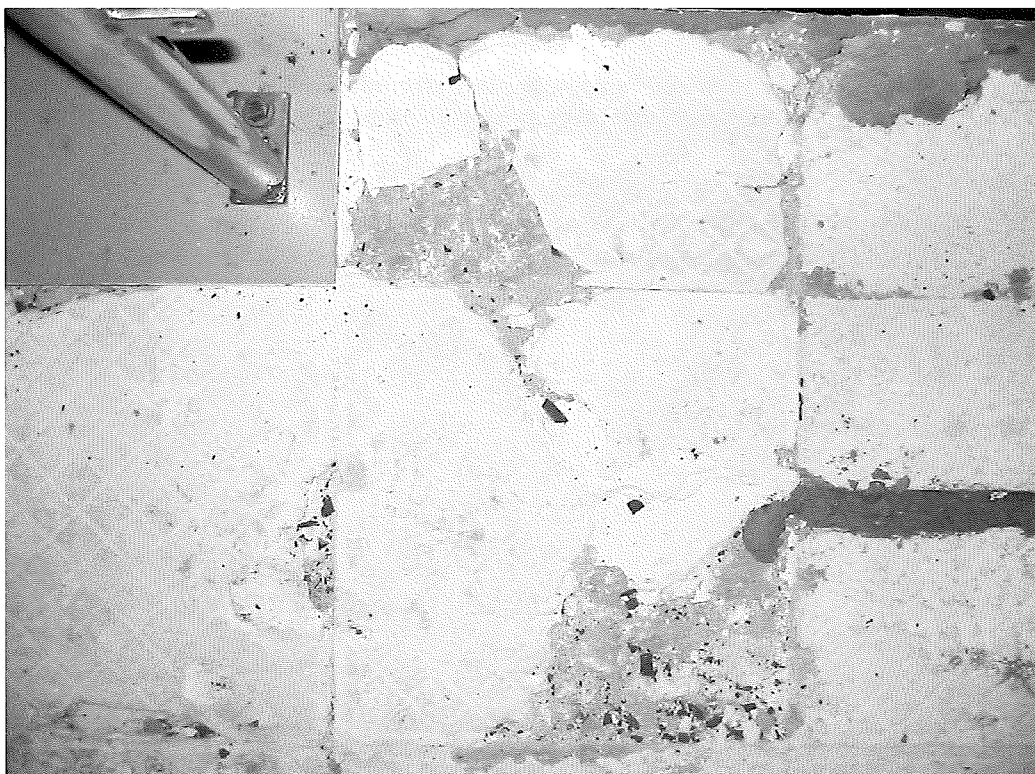
Figura nº 13. Desprendimiento de baldosas de gres, por irregular extensión del adhesivo (material de color blanco) y por colocar las baldosas con el "tiempo abierto" sobrepasado.
