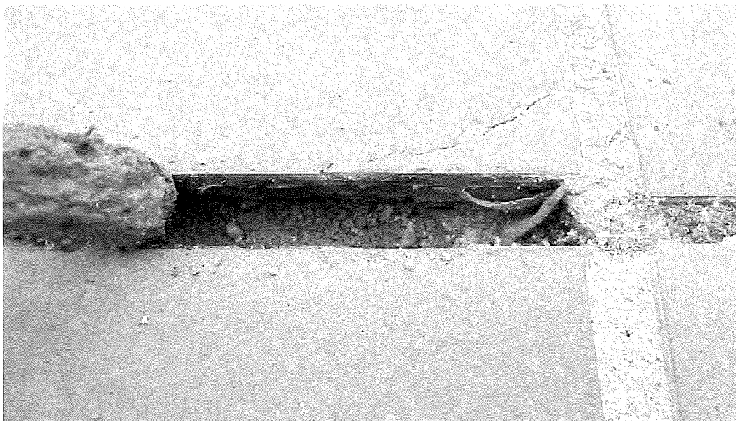
Figura nº 10. Junta de dilatación incorrectamente ejecutada (sólo afecta al pavimento y no es continua).
