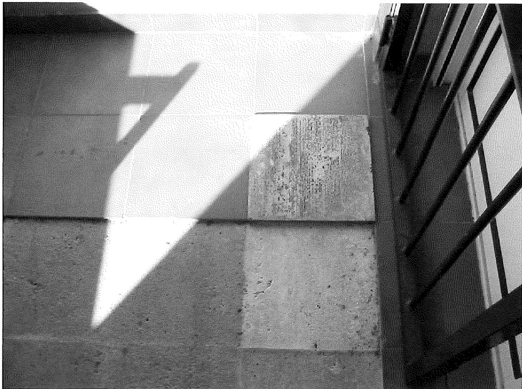
Figura nº 6. Pavimento exterior despegado.
