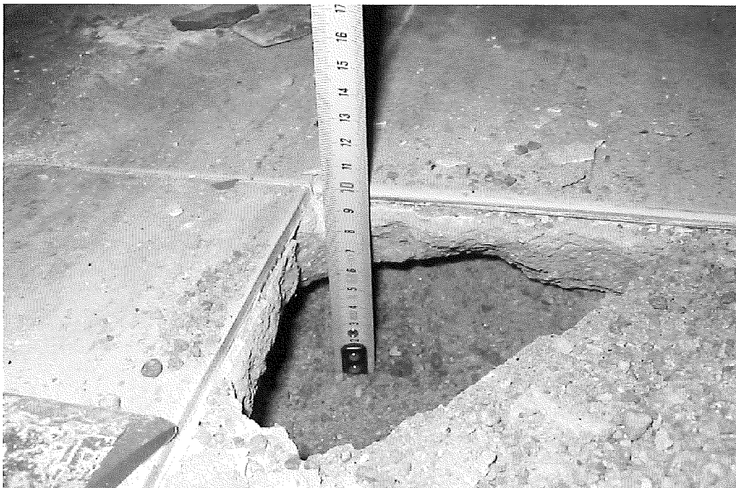
Figura nº 4. Medición del grosor de la capa de arena (6 cm) en un pavimento afectado por fisuras (obsérvese, también, la irregular granulometría de la arena).
