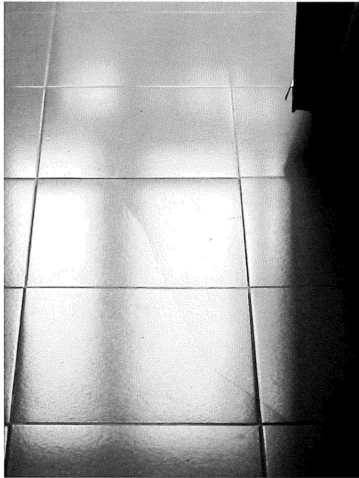
Figura n° 1. "Aguas" (parte superior) y fisuras de bordes cerrados (parte inferior).
