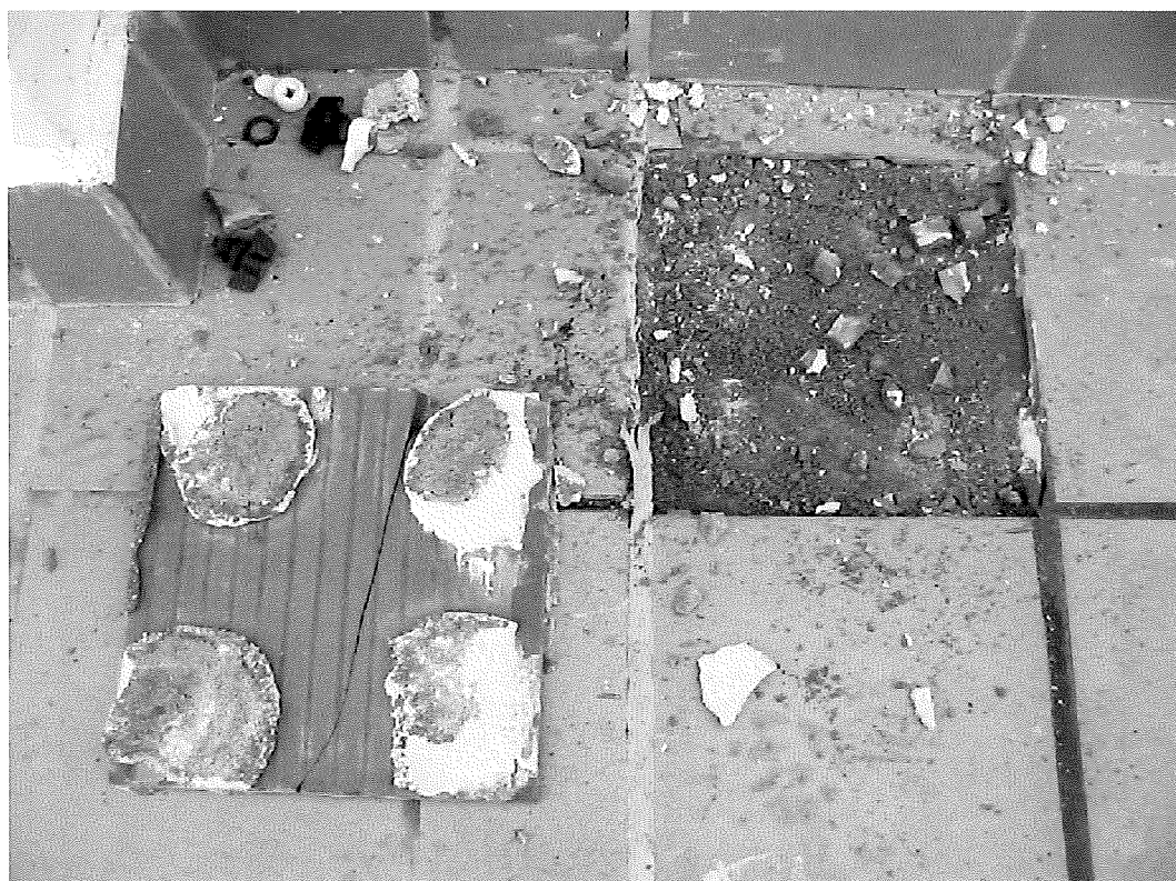
Figura nº 14. Desprendimiento de baldosas de gres, por irregular extensión del adhesivo, ("a la pellada" en el dorso de las piezas).
