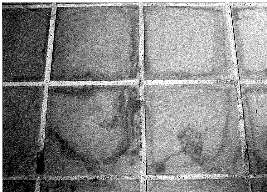
Figura nº 16. Manchas en baldosas cerámicas colocadas en una zona exterior impermeabilizada.
