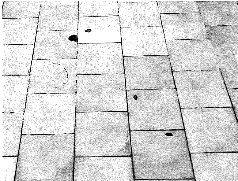
Figura nº 15. Desconchados en baldosas cerámicas colocadas en una terraza exterior impermeabilizada.
