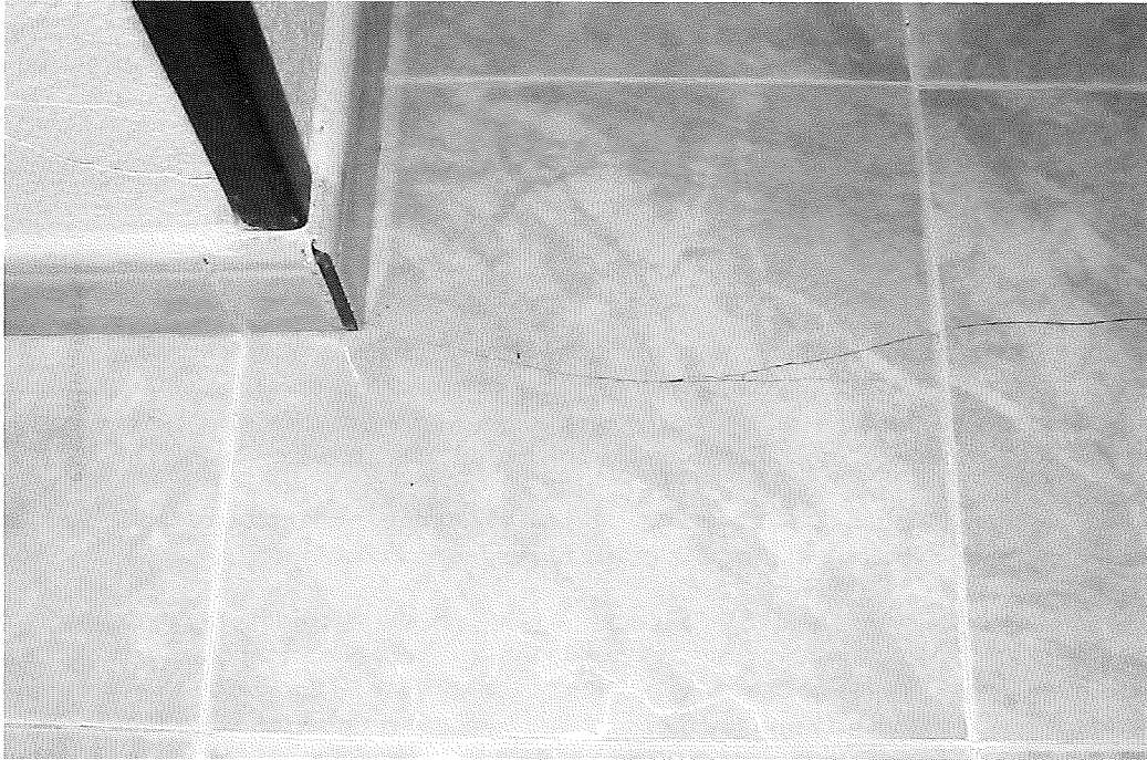
Figura nº 3. Pavimento fisurado por deformación excesiva del forjado (obsérvese que también afecta al tabique situado a la izquierda).
