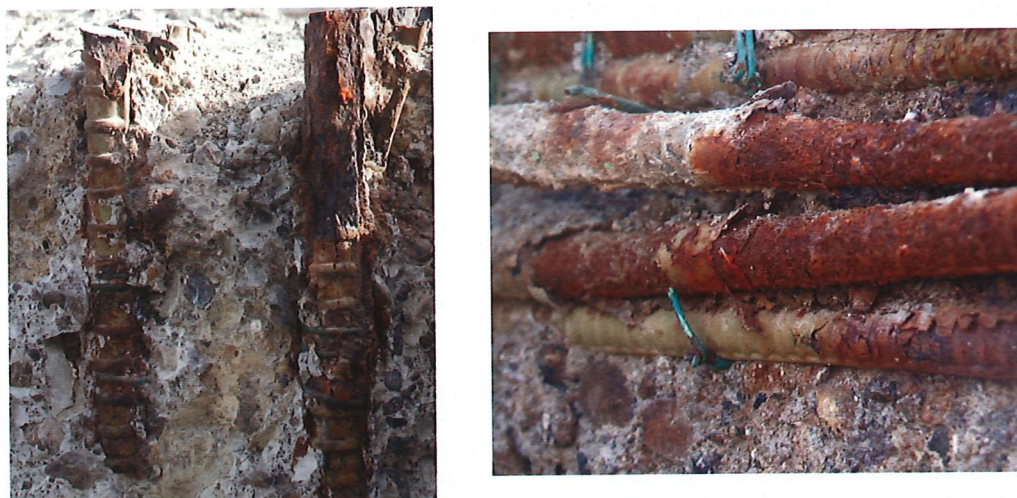
Figura 9: Estas dos fotografías muestran la falta de efectividad protectora frente a la corrosión de la armadura revestida con epoxy en las inmediaciones de las aguas salinas del Golfo Árabe o del Golfo Pérsico, en entornos calurosos y húmedos.
