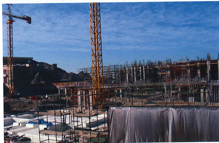
Figura 14: El complejo destinado al Palacio de Invitados de Omán. La armadura de acero inoxidable sólo se utiliza en las estructuras exteriores expuestas, desde debajo del nivel freático hasta 5 metros sobre rasante. El resto de la armadura es de acero negro.
