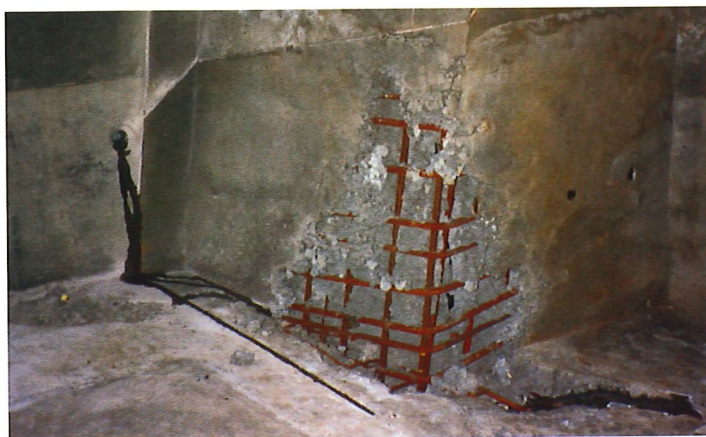
Figura 2: Coqueras típicas en una construcción nueva. Estos defectos de construcción obligan a reparar la mayoría de las grandes estructuras de hormigón de construcción reciente.
