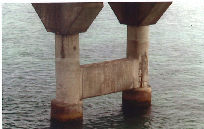
Figura 8: Puentes en los Cayos de Florida: daños críticos en los pilares debidos a la corrosión de la armadura revestida de epoxy.
