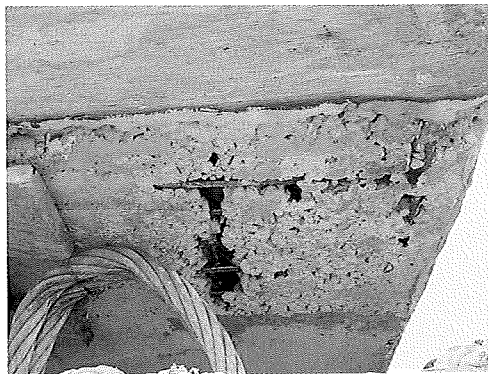
Defectos de hormigonado en unas vigas prefabricadas para un puente Concreting flaws in precast bridge beams Fig. 4
