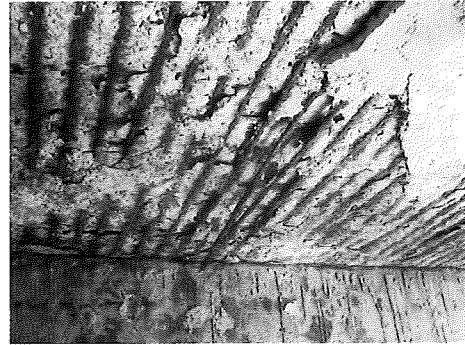
Daños en una estructura portuaria por corrosión de armaduras Reinforcement corrosion in a port structure Fig. 57
