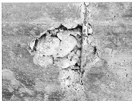
Defecto de compactación por excesivo tamaño de los áridos Consolidation flaws due to overly large aggregate Fig. 35
