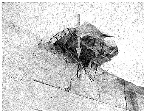
Fisura en un dintel que recibe una carga puntual próxima a un apoyo Cracks in the web of a precast beam Fig. 18
