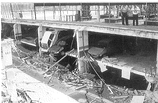
Hundimiento de un edificio de aparcamiento Collapse of a car park building Fig. 7
