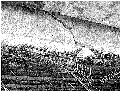
Daños por corrosión en vigas prefabricadas en ambiente marino Corrosion damage in precast beams in a marine environment Fig. 11
