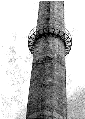
Daños en una chimenea de una refinería de petróleo Damage in an oil refinery smokestack Fig. 56
