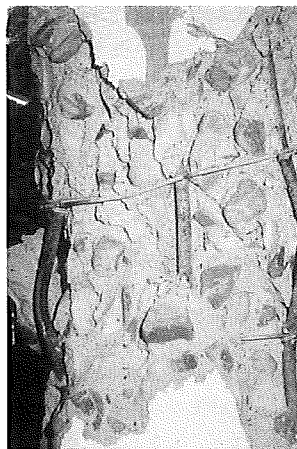
Colapso de un pilar adyacente a otro que había asentado Collapse of a column adjacent to a subsiding support
