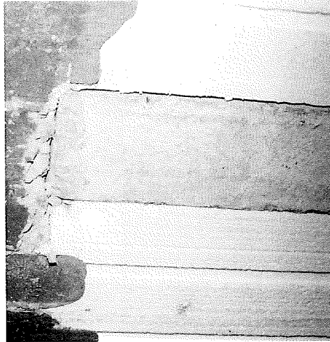
Despegue de una vigueta de forjado Detachment of a slab joist Fig. 3
