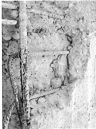
Daños en un muro de hormigón por movimientos en el encofrado Damage to a concrete wall due to formwork movement Fig. 44
