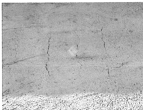
Fisuras por asiento plástico del hormigón en cara superior de una zapata Cracks due to concrete plastic creep at the top of a footing Fig. 36
