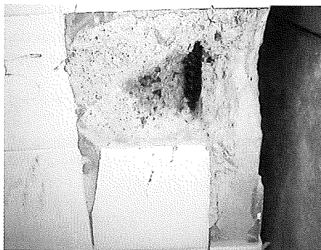
Daños por corrosión en armaduras a las que ha llegado el frente carbonatado Corrosion in reinforcing steel attacked by the carbonated front Fig. 33
