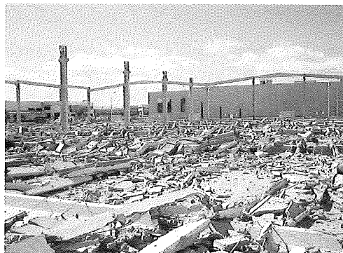
Hundimiento de una nave durante su montaje Crack on a lintel subject to a point load near a support Fig. 17
