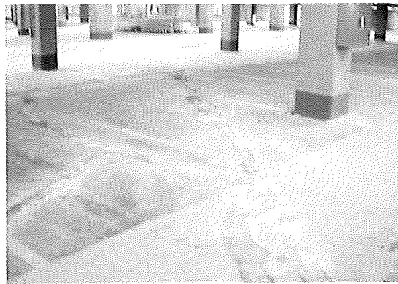
Daños en una placa de cimentación por una incorrecta materialización de las juntas de hormigonado Damage to a foundation slab caused by improper execution of the construction joints Fig. 52
