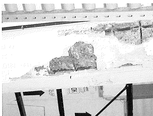
Daños por corrosión de armadura en un hormigón muy permeable Corrosion of reinforcing steel in very permeable concrete Fig. 32
