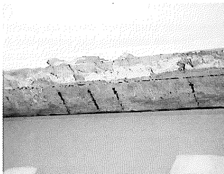
Insuficiente recubrimiento de la armadura inferior en una pieza hormigonada in situ Insufficient cover on bottom rebar in a cast-in-place member Fig. 40
