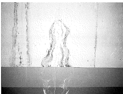
Fisuración en un muro por retracción y contracción del hormigón Cracks in a wall due to concrete shrinkage and contraction Fig. 29
