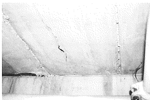
Fisuras en losas alveolares por la irregularidad superficial de su plano de apoyo Cracks in waffle slabs due to a warped support surface Fig. 46
