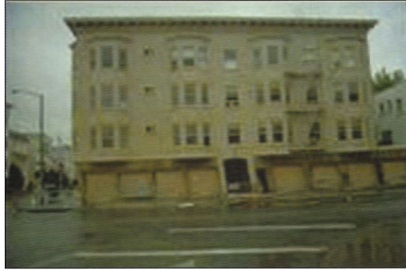
Foto a). Fallo por planta débil. Photo a). Soft storey-mechanism.
