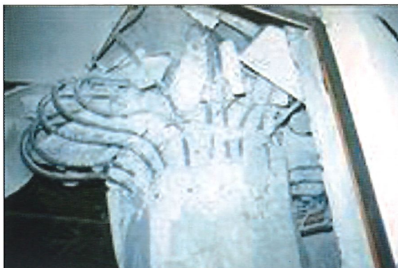
Foto d). Fallo de un pilar. Apréciese la falta de cercos.
