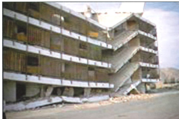
Foto c). Terremoto de Perú, 1968. Photo c). Peru earthquake, 1968.
