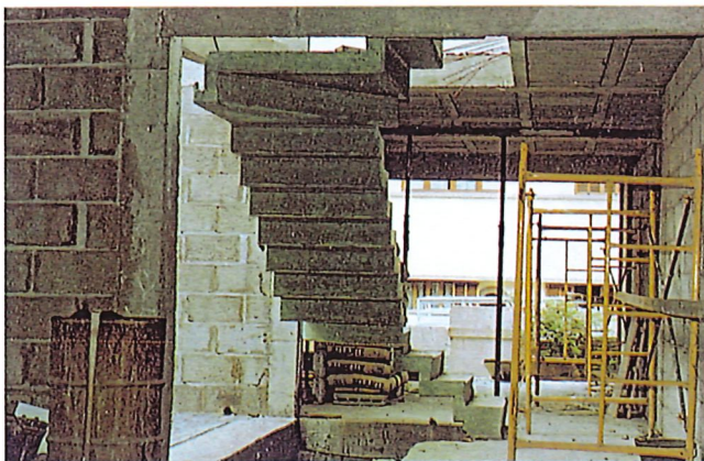
Escalera encofrada con tablero aglomerado. Formica. Sin desencofrante.
