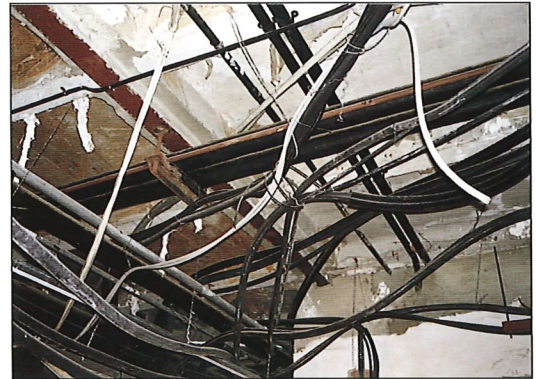
Fotografía N° 4. Tendido de canalizaciones en obras de reforma. Photograph No. 4. Raceways laid in remodelling project.
