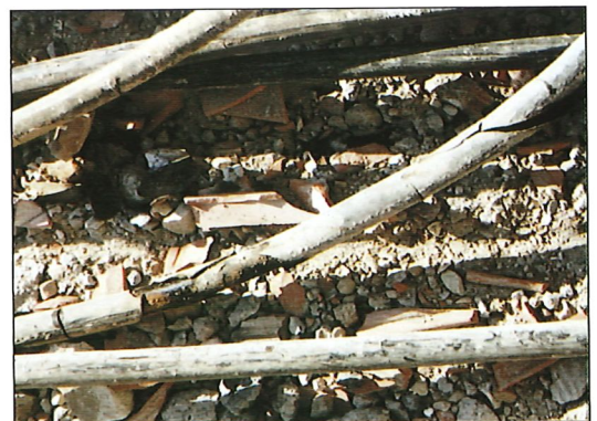
Fotografía N° 18. Cristalización del aislamiento de cables eléctricos. Photograph No. 18. Crystal formation on electric wire insulation.
