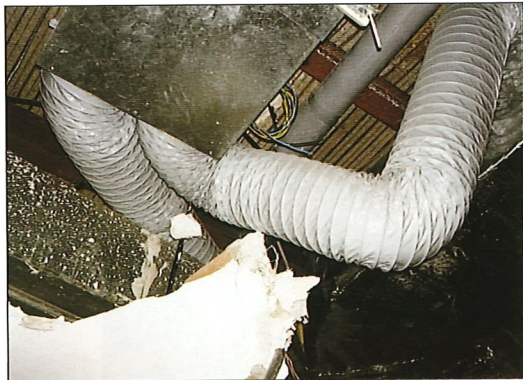
Fotografía N° 15. Mala utilización de conductos flexibles en redes de aire de instalaciones de climatización. Photograph No. 15. Improper use of flexible ductways in AC systems.
