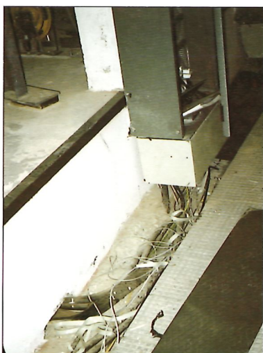
Fotografía N° 11. Mala ejecución de canaleta e incorrecto tendido de cables en instalaciones de ascensores. Photograph No. 11. Poor workmanship on raceways and incorrectly laid wires in lift.
