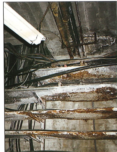
Fotografía N° 16. Deterioro de redes de distribución eléctricas por fugas de agua en tuberías. Photograph No. 16. Damage to electric grids due to leaky pipes.
