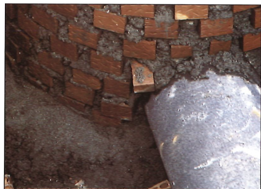
Fotografía N° 24. Ejecución incorrecta de la conexión de un tubo de saneamiento con un pozo de registro. Photograph No. 24. Inadequate connection between drainage pipe and manhole.
