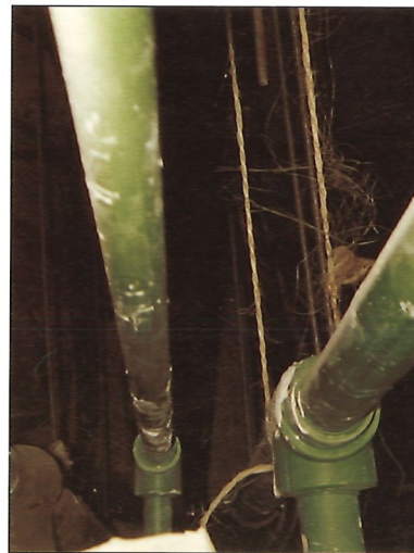
Fotografía N° 22. Soluciones no adecuadas para soportar tuberías. Photograph No. 22. Inappropriate pipe supports.
