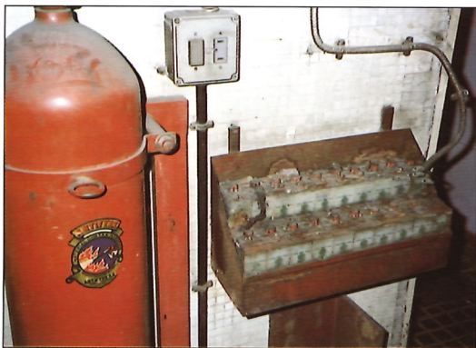
Fotografía N° 23. Deterioro de un sistema de protección contra incendios por falta de mantenimiento. Photograph No. 23. Deterioration of a fire protection system due to lack of upkeep.
