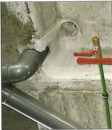
Fotografía N° 13. Daños causados en elementos estructurales por el paso de instalaciones (defectos en el replanteo). Photograph No. 13. Damage to structural members to allow for service passageways (stake-out errors).
