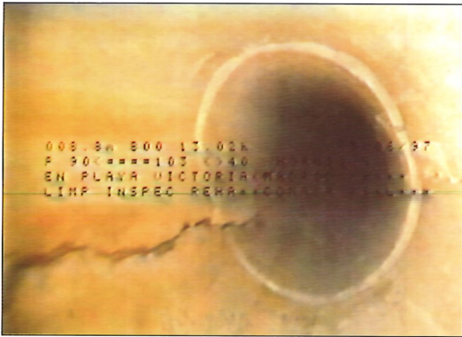
Fotografía N° 21. Rotura de tubos de saneamiento enterrado, observada desde su interior. Photograph No. 21. Broken pipes in below grade collection system, view of interior.
