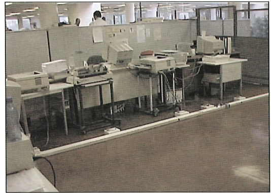
Fotografía N° 2. Mala implantación de tomas de corriente en reformas de oficinas. Photograph No. 2. Poorly installed outlets in remodelled office.
