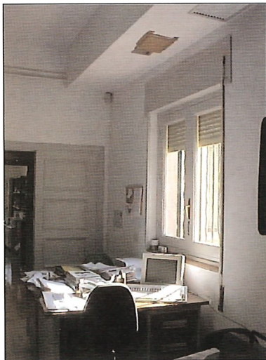
Fotografía N° 3. Impulsión de aire acondicionado tapada como consecuencia de un diseño inadecuado. Photograph No. 3. AC delivery obstructed due to inappropriate design.
