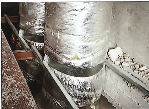
Fotografía N° 5. Soportes no correctos de conductos de aire de una instalación de climatización. Photograph No. 5. Use of wrong supports in AC ducts.
