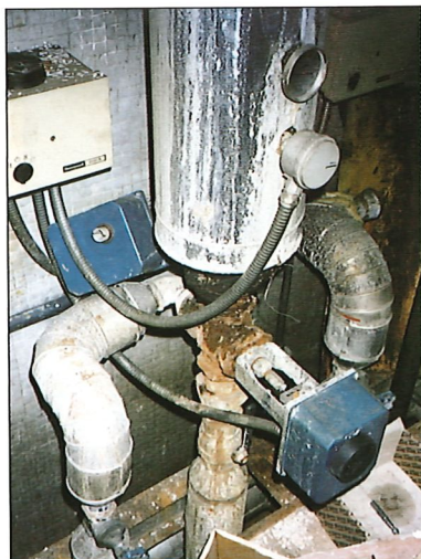
Fotografía N° 17. Deterioro de una red de producción de agua caliente sanitaria por mala conservación. Photograph No. 17. Deteriorated hot water grid due to poor upkeep.
