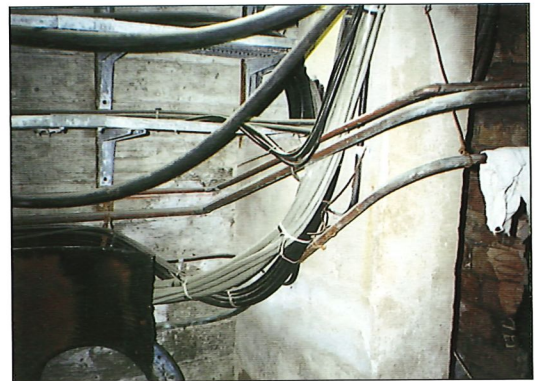
Fotografía N° 14. Inadecuada conservación de redes de gases medicinales en un hospital. Photograph No. 14. Inadequate upkeep of medicinal gas facility in a hospital.
