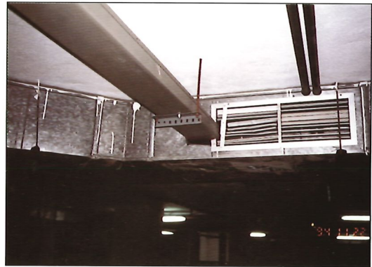
Fotografía N° 20. Interferencias entre distintas instalaciones. Photograph No. 20. Interference between services.
