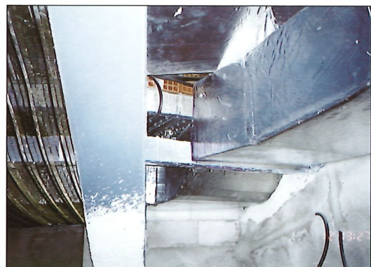
Fotografía N° 12. Reducción brusca de un conducto de aire para salvar un elemento estructural. Photograph No. 12. Abrupt downsizing of an air ductway to by-pass a structural member.
