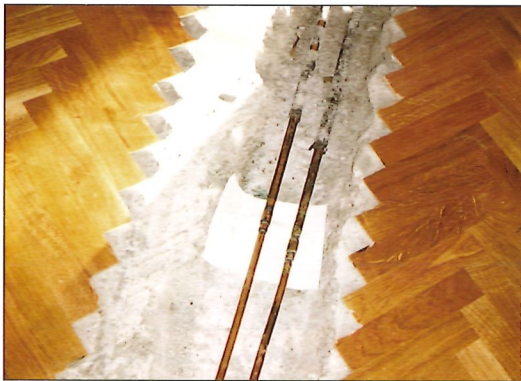
Fotografía N° 9. Fallos en soldaduras de tubos de cobre en instalaciones de calefacción empotradas. Photograph No. 9. Weld failures in cooper pipes in encased heating systems.
