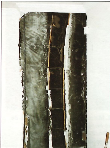
Fotografía N° 7. Shunt de evacuación de humos no estanco por defectos de ejecución. Photograph No. 7. Exhaust duct not airtight due to poor workmanship.
