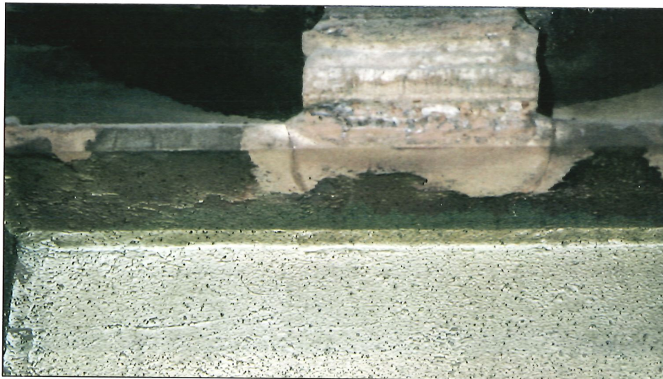
Fotografía nº 8: Fisuras en una viga carrilera.
