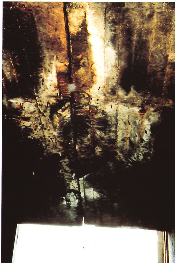
Fotografía n° 6: Daños por lixiviación (deslavado) del hormigón y corrosión en la cara inferior del tablero de un muelle. Photograph No. 6: Lixiviation (leaching) damage to concrete and corrosion on the under side of a pier deck.
