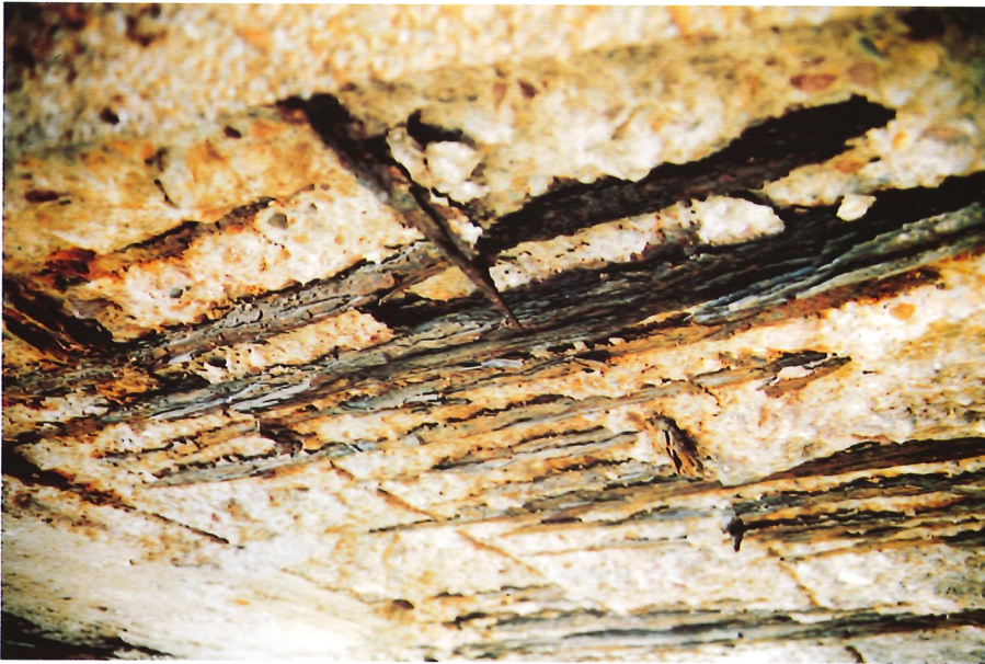
Fotografía n° 5: Detalle de los daños que presenta el hormigón armado del emisario. Photograph No. 5: Detail of the damage to the reinforced concrete outlet.
