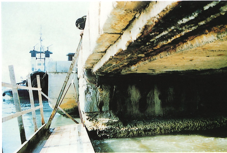
Fotografía nº 3: Degradación química del hormigón y de las armaduras en zona portuaria.
