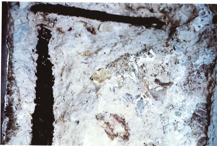
Fotografía n° 9: Detalle de un pilar de la estructura de una estación depuradora de aguas salobres, deteriorado por la acción del sulfato magnésico.
