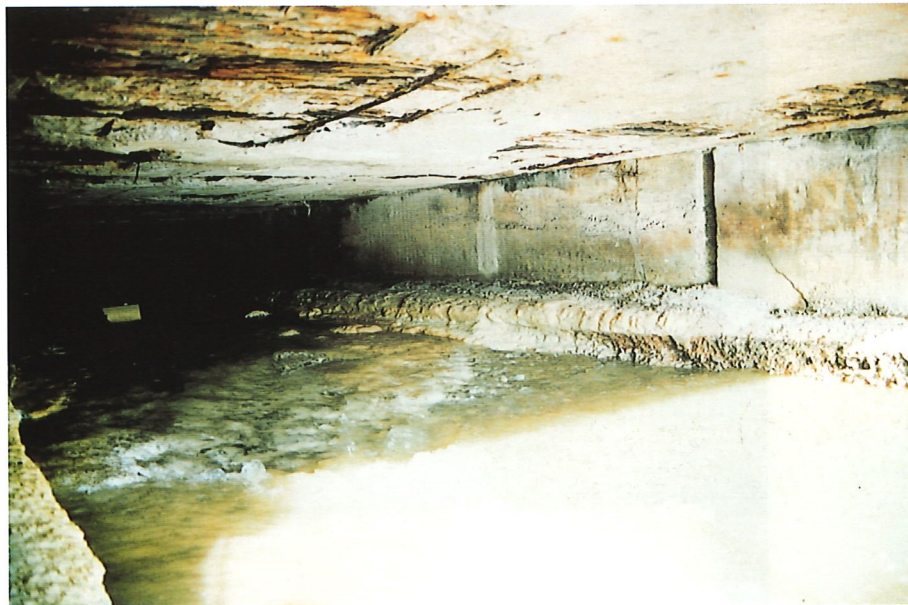
Fotografía nº 4: Daños por ataque químico al hormigón y posterior corrosión de armaduras en el tramo final de un emisario que desemboca en la dársena de un puerto.
