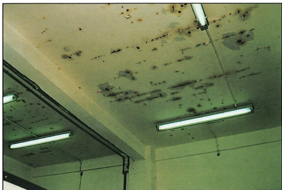
Fotografía nº 1. OBRA 1. Daños por corrosión en la reparación de forjado. Photograph No. 1. WORKS 1. Corrosion damage in repaired flooring.
