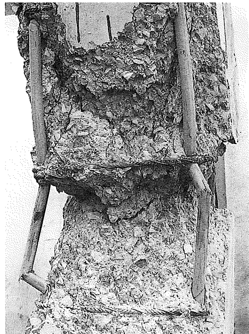
Fig. 6-8. Rotura de pilar de serie D (pilar D-4) Fig. 6-8. Series D column failure (column D-4)
