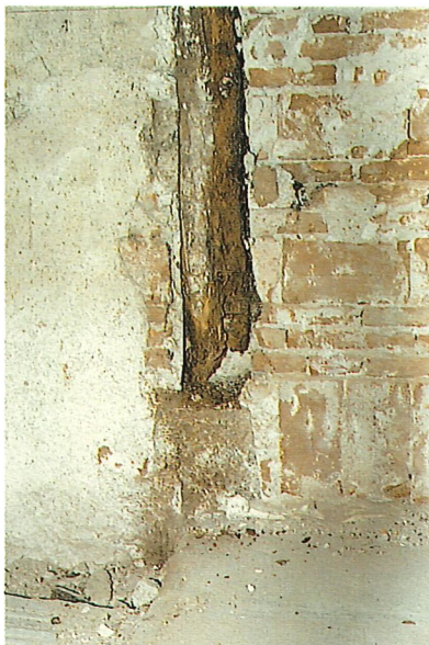
1. PIE DERECHO ATACADO POR LA HUMEDAD PESE A DISPONER DE UN PLINTO DE PIEDRA. 1. UPRIGHT ATTACKED BY DAMP IN SPITE OF STONE BASE.
