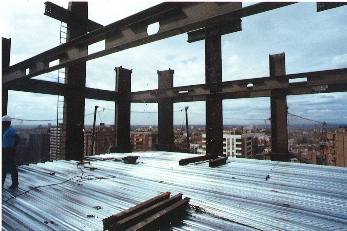
Fotografía n.º 1. Colocación preliminar de la chapa. Photograph No. 1. Preliminary placing of the steel sheet.
