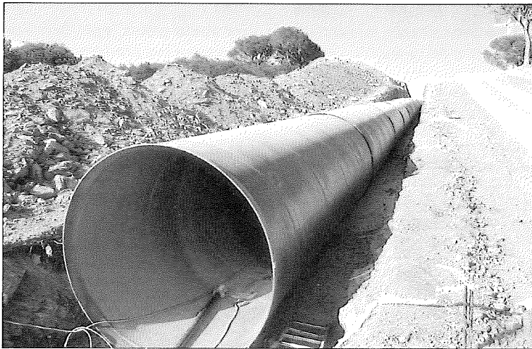
Foto 4. Tubería de impulsión N° 1. Photo 4. Lead Line No. 1.
